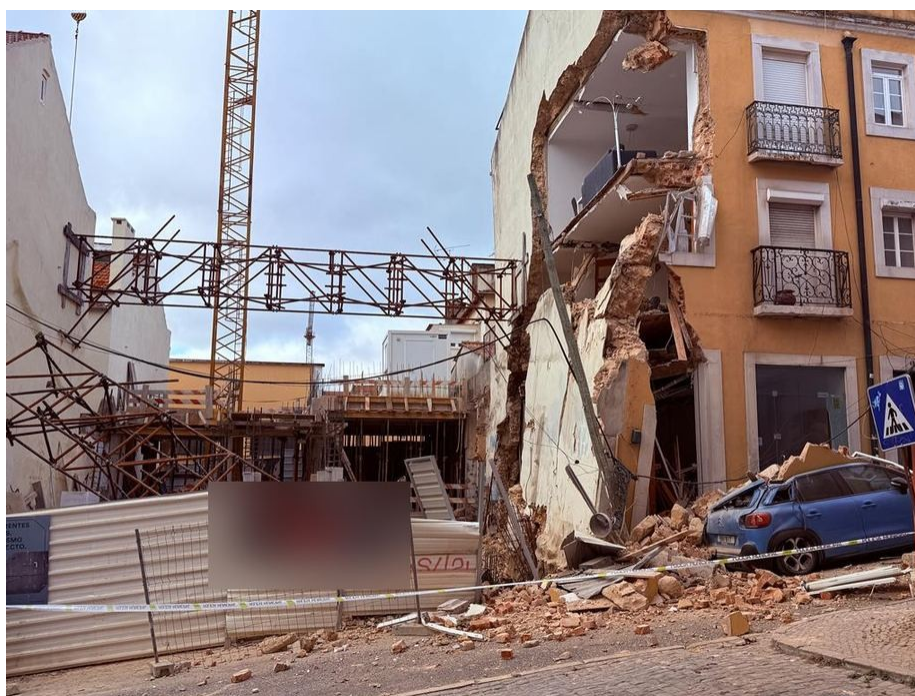
Fig. 3 — Consequências do incidente, Rua do Sol à Graça, Lisboa, setembro de 2025. A falha ocorreu do lado do edifício que já dependia do suporte mostrado nas Figs. 1 e 2. A sinalização do local que identifica o empreiteiro foi ocultada; a responsabilidade pelo incidente permanecia formalmente indeterminada à data de redação.
